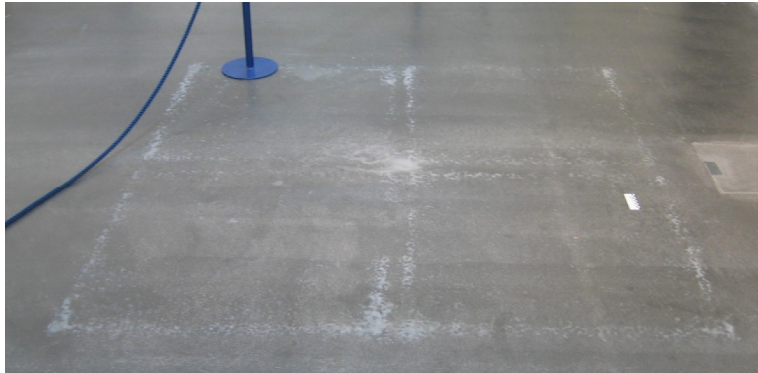
Bild 3: Spuren des von einem Oberlicht abtropfenden Tauwassers auf dem Magnesia-Estrich der Ausstellungshalle
